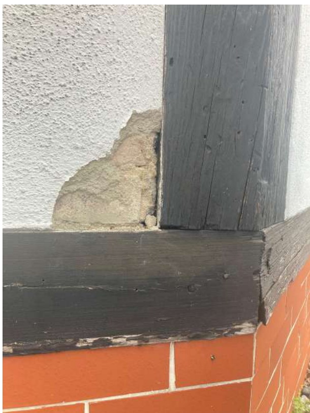
Fot. 12. Ubytki w tynku, detal
