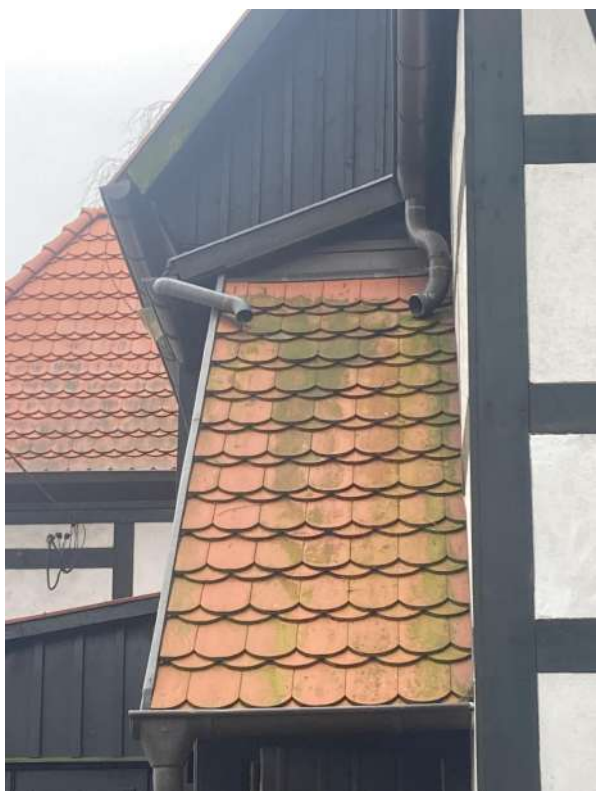
Fot. 22. Dach i rynny nad schodami na balkon
