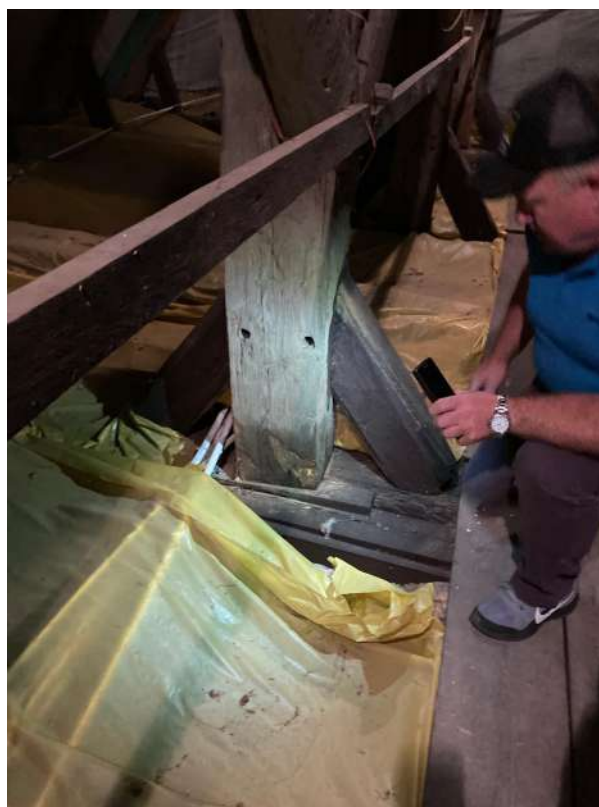
Fot. 31. Folia PCV, zniszczone słupy, poddasze
