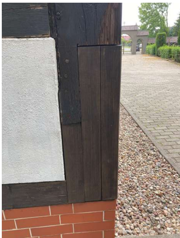
Fot.8. Łączenia słupów, wtórne element ;
