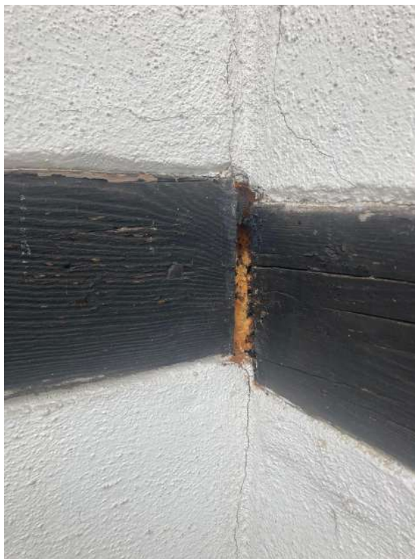
Fot. 13. Zniszczenia belek, detal
