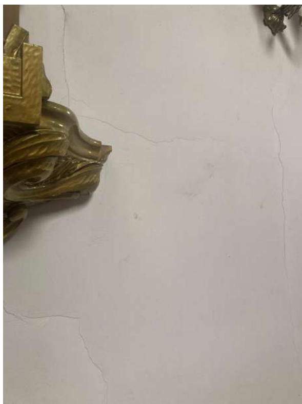
Fot. 58. Pęknięcia na ścianach, detal, kaplica
