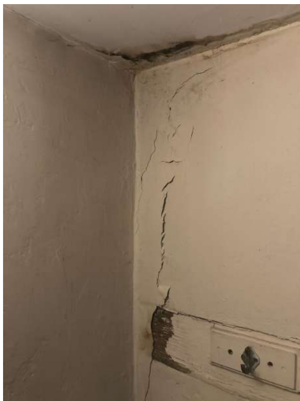
Fot. 55. Pęknięcia na ścianach, detal
