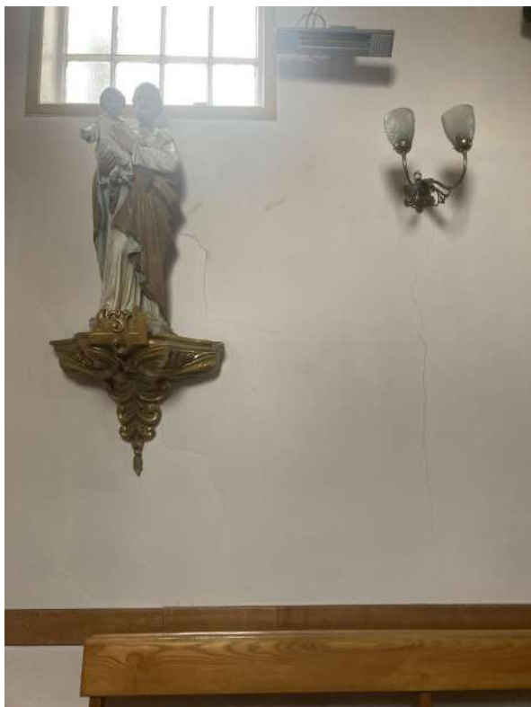
Fot. 57. Pęknięcia na ścianach
