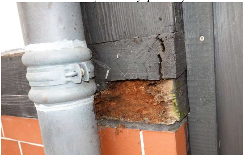
Fot.13. Spróchniała podwalina przy rurze spustowej.
