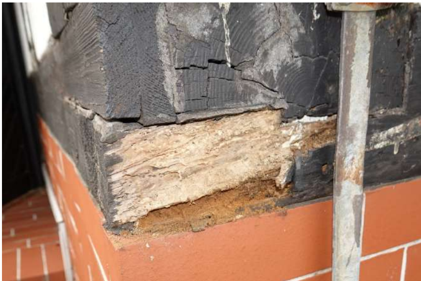
Fot.12. Głęboka korozja podwaliny..
