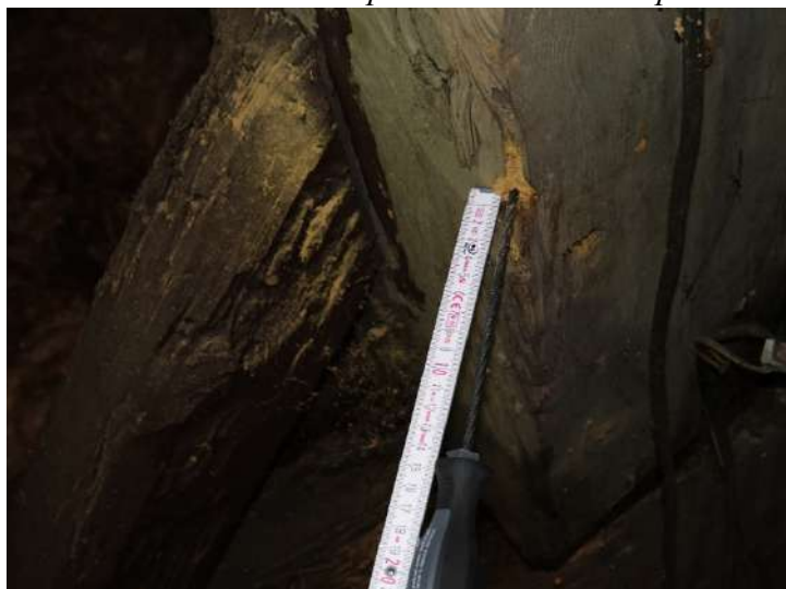
Fot.19. Korozja dolnej części słupa w osi kalenicy oraz zastrzałów. Głębokość korozji 3,5 cm.
