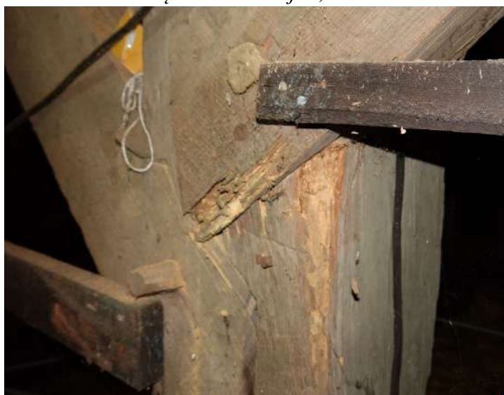
Fot.20. Korozja górnej części słupa.
