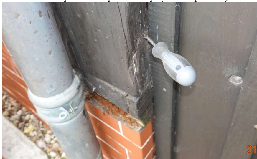
Fot.14. Spróchniały słup konstrukcji drewnianej przy rurze spustowej. Szpikulec wchodzi bez oporów prawie na pełną głębokość.
