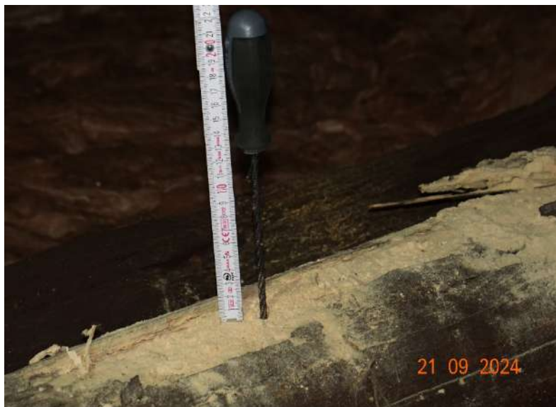
Fot.15. Całkowicie skorodowane okrągłaki wzmacniające belki stropowe. Głębokość penetracji 5,5 cm
