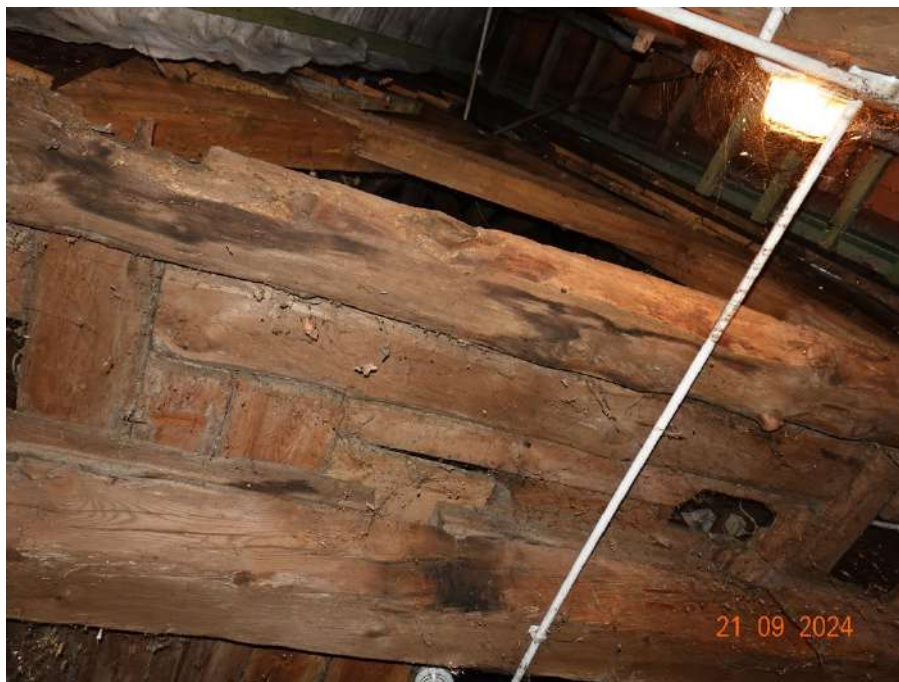
Fot.21. Uszkodzona konstrukcja wieży.
