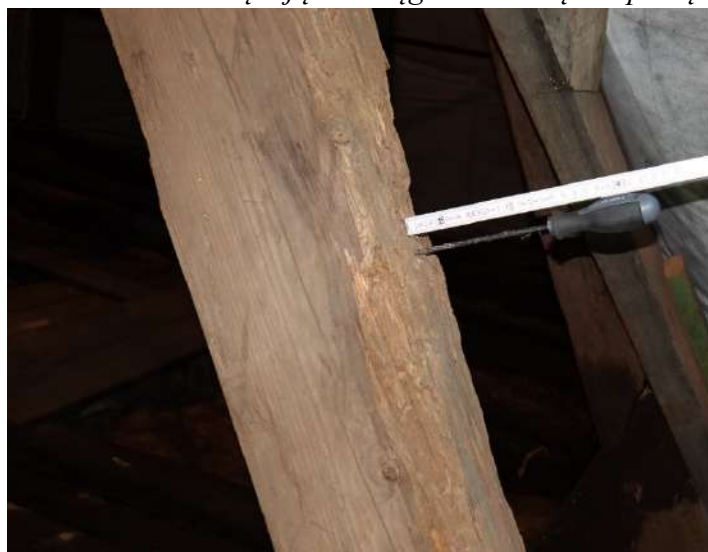
Fot.17. Silnie skorodowana krokiew. Głębokość penetracji 4,5cm.
