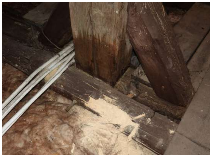
Fot.18. Skorodowana pierwotna belka stropowa.
